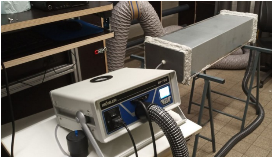
Abbildung 2.1: Prüfaufbau Luftkanal mit angeschlossenem Dichtheitsprüfgerät DP700
